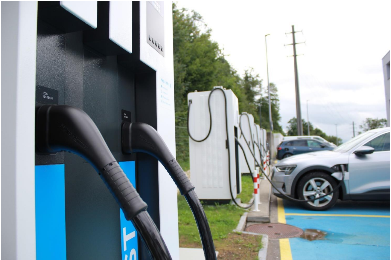
Die neu ausgerüsteten Schnellladestationen beim Freshbalken in Würenlos. © BRUGG eConnect AG
